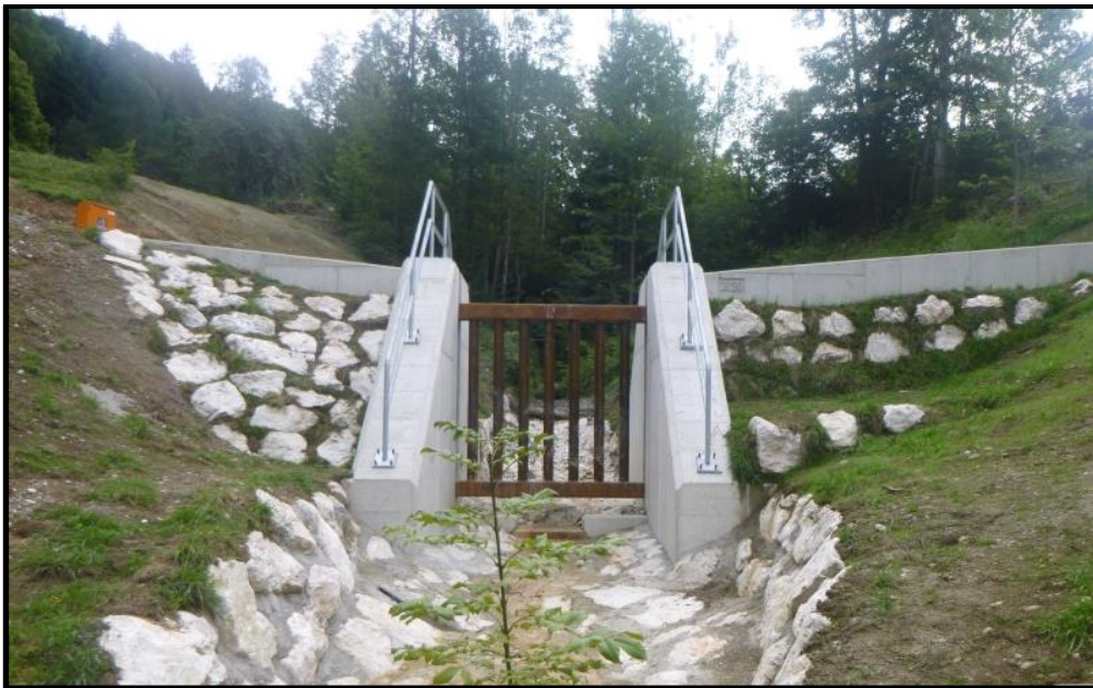
Geschiebe- und Wildholzrückhaltesperre am Lettengraben Foto:Wasserwirtschaftsamt Traunstein
